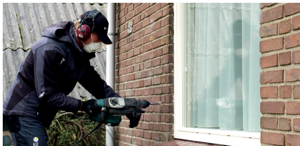
Vele vooroorlogse Zaanse woningen hebben goede isolatie en funderingsherstel nodig. Beelden gemeente Zaanstad
